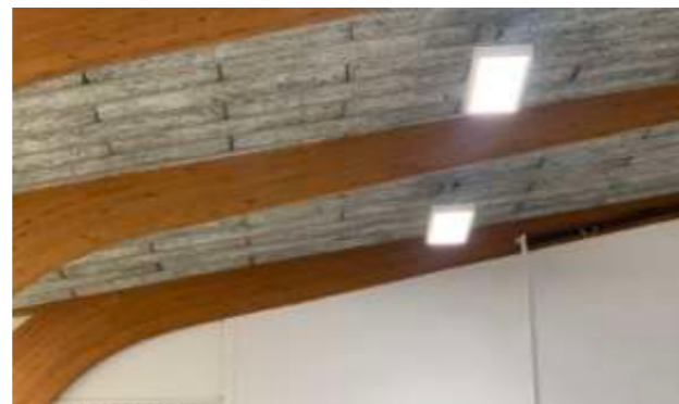
Eclairage salle 4 Septembre
