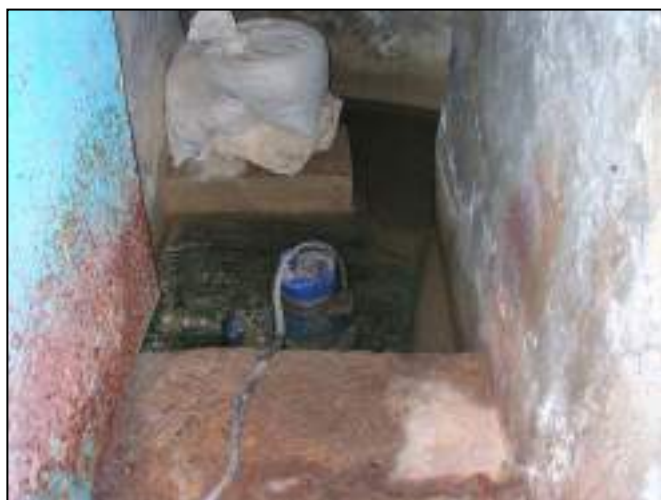
Bêche et Pompe alimentant les fontaines publiques (photo 2006)
