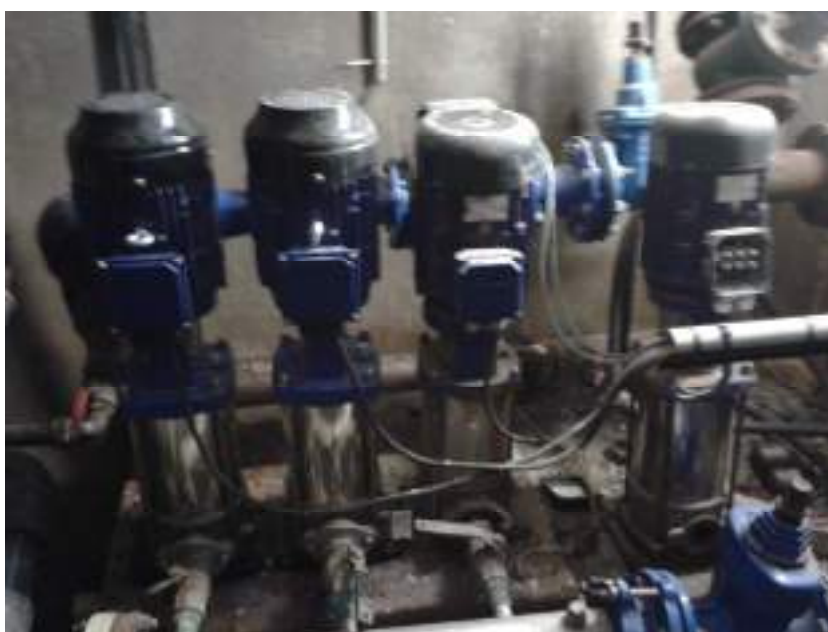
Les trois pompes du surpresseur
