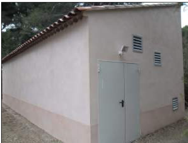
Station de filtration (capacité 2 x 40 m 3 /h)
