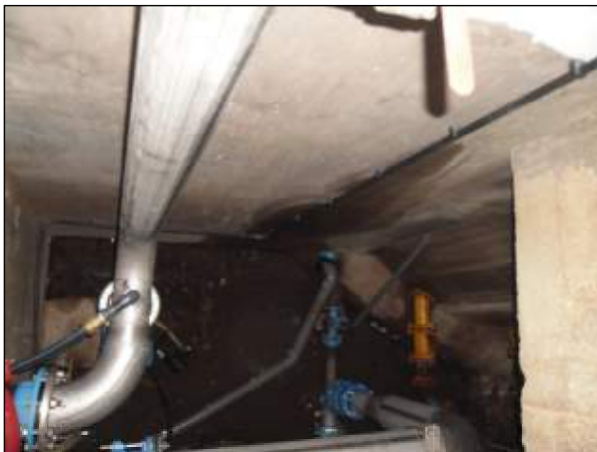
Accès au surpresseur / Présence d'eau sur plancher
